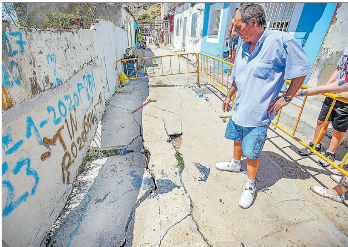
La calle está situada en un barrio de la ladera de la sierra y tiene peligro de derrumbe. TONY SEVILLA
